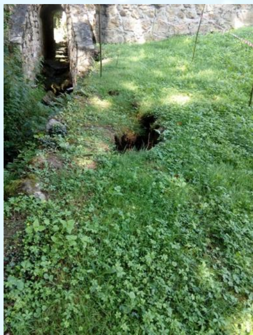
Affouillement des berges
