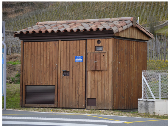
Exemple de local pour transformateur électrique
