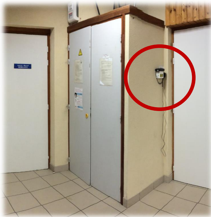
Vers armoire éclairage
